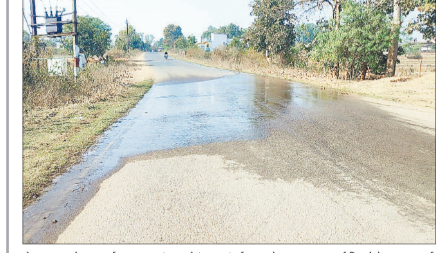
बैकुण्ठपुर। सोनहट मार्ग पर जनपद पंचायत बैकुण्ठपुर अंतर्गत ग्राम चेरवापारा मुख्य मार्ग किनारे पेयजल सपलाई पाइप लाईन से पेयजल प्रतिदिन बर्बाद होकर सड़क पर बह रहा है। ऐसा कार्फा समय से चल रहा है, जिसे ठीक करने ध्यान नहीं दिया जा रहा है।
